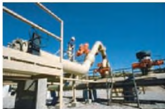
▲ Figura 10.15 Intersección de tuberías de gas natural.
